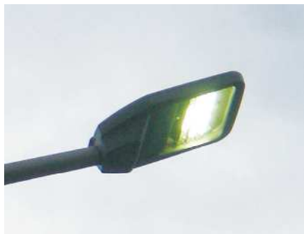
LED照明灯 (潮風橋)
