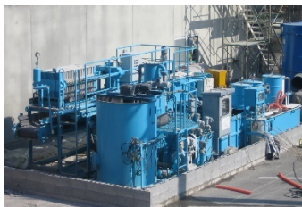
凝集沈殿装置
